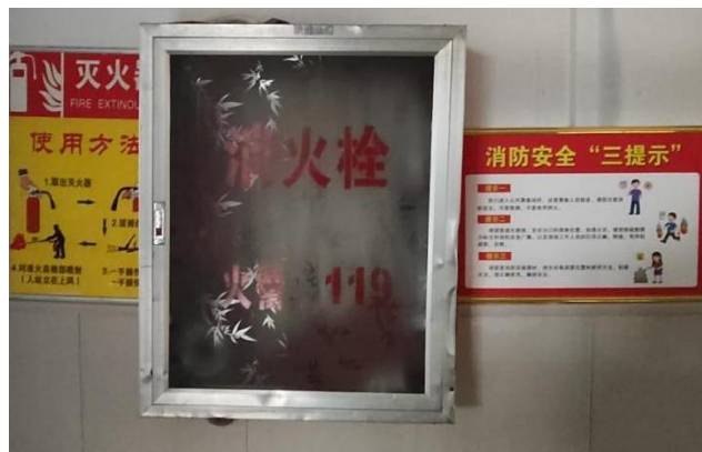
图 7-10 消防设施（政教处）
